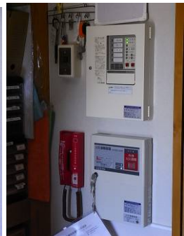
【火災報知器管理】
