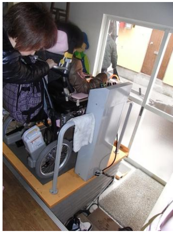
【玄関の昇降機】
